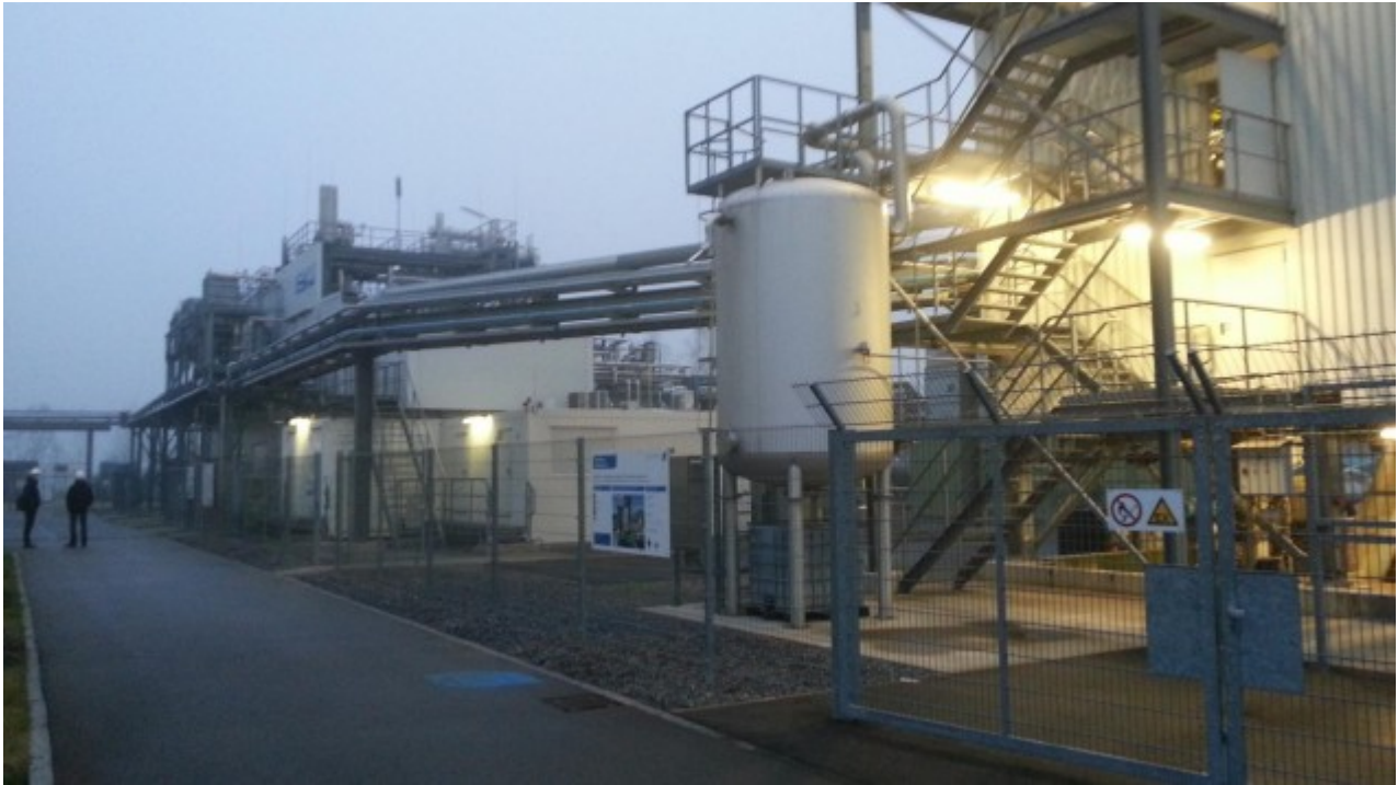
In Freiberg hängt das eine mit dem anderen zusammen: vorn rechts die Schlackebadvergasungsanlage zur Wasserstofferzeugung, hinten links die Anlage zur Erzeugung synthetischen Benzins der Firma CAC. (Deutschlandradio / Frank Drescher)
